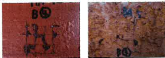
写真11 黒皮からの発錆
